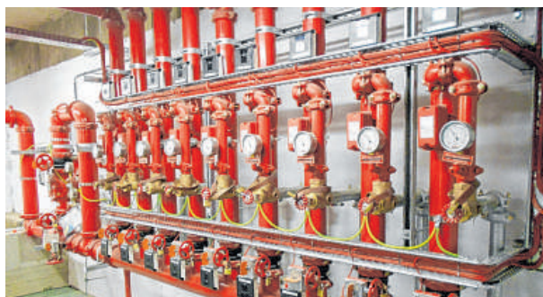
Sprinkleranlagen wie diese sind in Tiefgaragen und Kaufhäusern Pflicht. Sie zu montieren und zu warten lernen die Teilnehmer in der Weiterbildung. FOTO: ZFB
